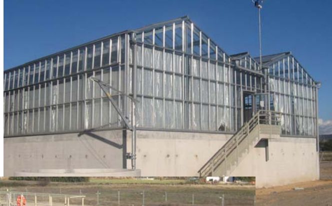
La station d'épuration.
